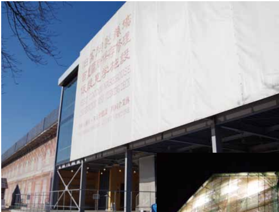
富岡製糸場西置繭所に設置された 保存修理工事の見学施設
