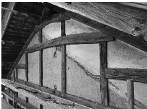
屋根の傾斜の痕跡
