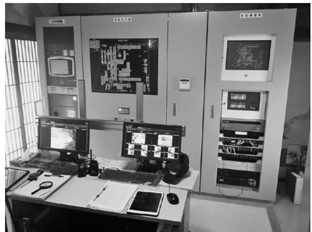
防災設備を設置した社宅85室内
